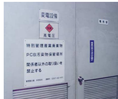
施錠のうえ厳重に管理
