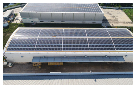
ニッシンフーズタイランドの工場で設置されている太陽光パネル。
